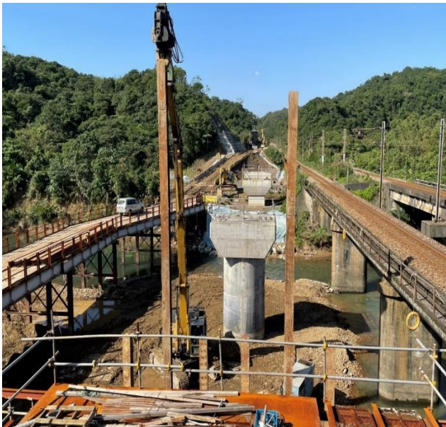
圖 58：臺鐵宜蘭線第三新雙溪鐵路橋梁，在第二代東西正線上游施做新橋梁，是否可保留舊橋以因應急需值得在省思考慮。(賴品寬攝)
