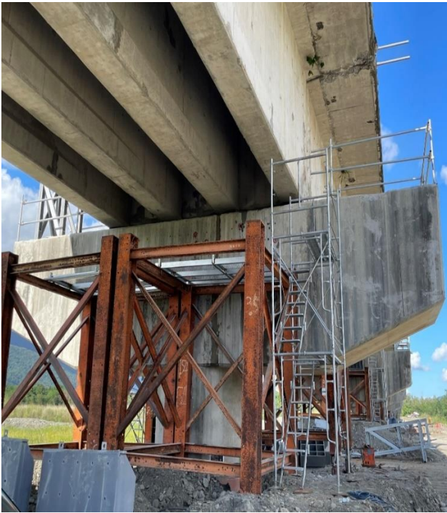
圖 51：2022 年 918 池上地震臺鐵新秀姑巒溪橋橋梁墩柱修復使用工字梁施工架圖。(賴品寬攝)
