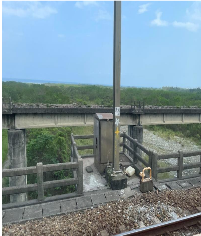
圖 60：臺鐵北迴線新城鐵路橋梁與下游舊橋相望，可否繼續保留來就近備援應急。(賴品寬攝)
