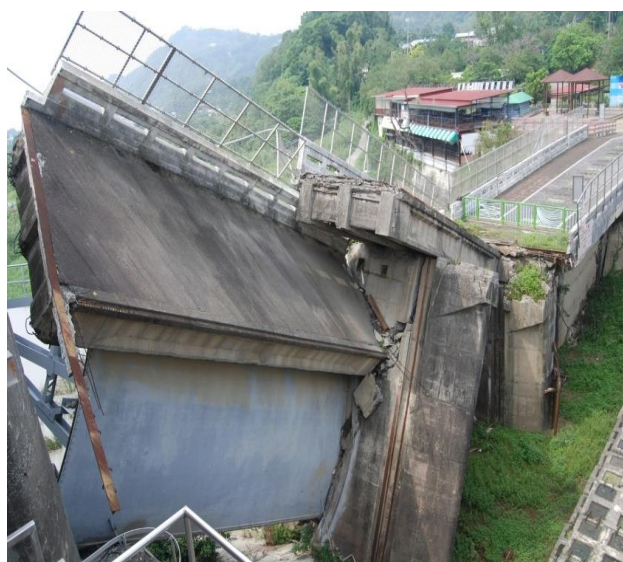
圖 14：921 大地震車籠埔斷層對臺中石岡壩主壩逆衝切斷破壞整個壩體。(賴明煌攝)
