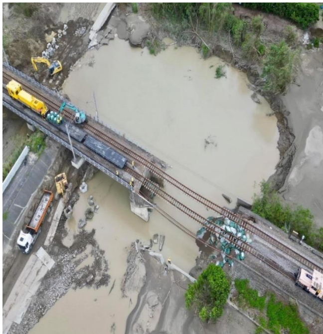
圖 66：臺鐵縱貫線八掌溪鐵道橋南側潰堤釀鐵沖毀(摘自「台南式 Tainan Style」)。 道路基被沖毀而懸空(摘自「台南式 Tainan Style」)。
