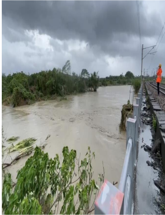
圖 65：臺鐵縱貫線八掌溪鐵道橋南側溢堤與潰堤釀鐵沖毀(摘自「台南式 Tainan Style」)。
