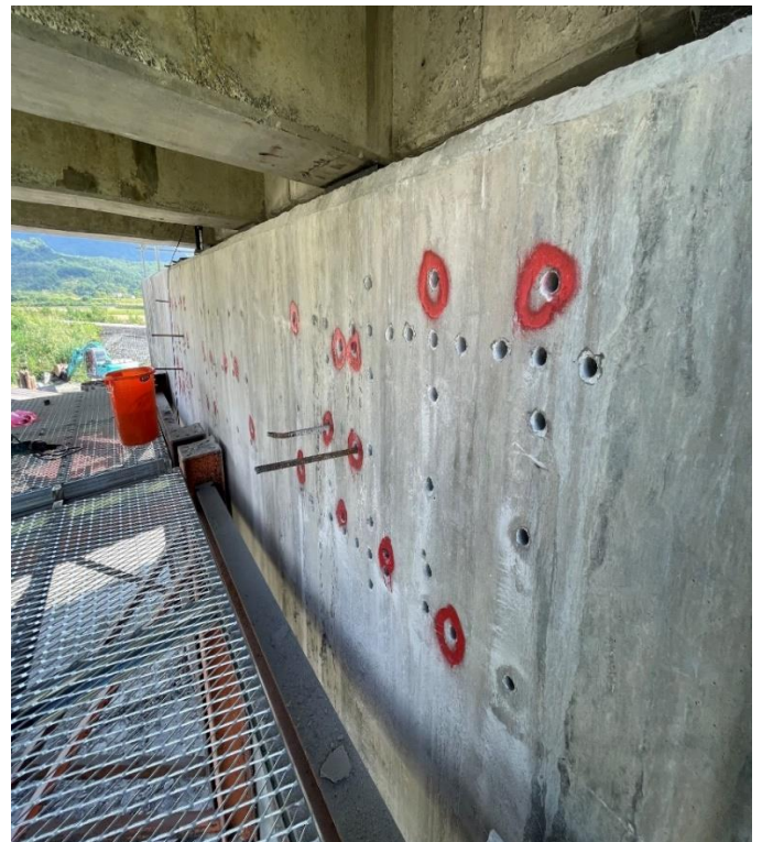
圖 54：臺鐵新秀姑巒溪橋原帽梁鑽孔雖有金屬偵測器但鋼筋密排，釀植筋頗困難之圖。(賴品寬攝)
