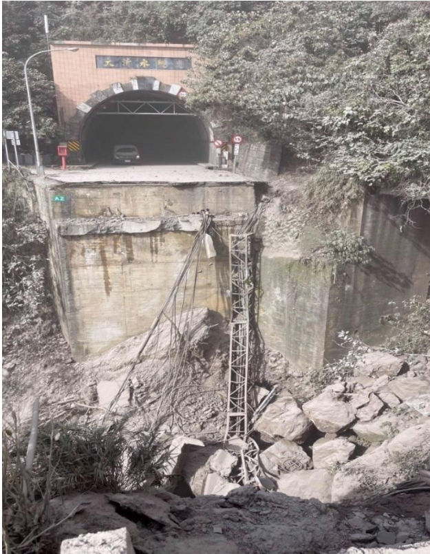
圖 3：省道台 9 線下清水橋遭 403 花蓮大地震所震，落橋梁與橋台橋墩現況。摘自中時報 20240404。
