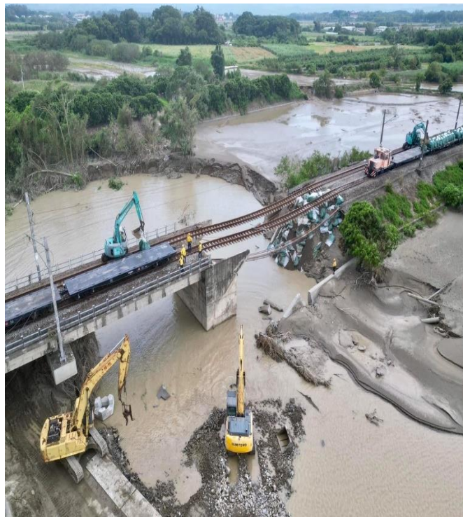
圖 68：臺鐵縱貫線八掌溪鐵道橋南側溢堤與潰堤致路基懸空(摘自「台南式 Tainan Style」)
